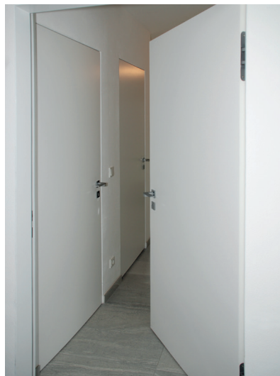
... und Bändern, die bei geschlossener Tür in der Zarge verschwinden. (Bild 47c91296)
